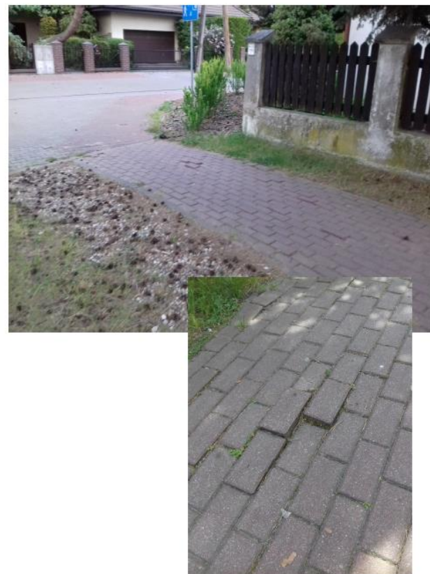
ul. Zdrojowa przy chodniku od ul. Matysiaków do sklepów
